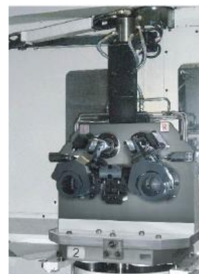
Přívod media pomocí ramene. Celkem 6 rozvodných potů s tlakem 250 bar
